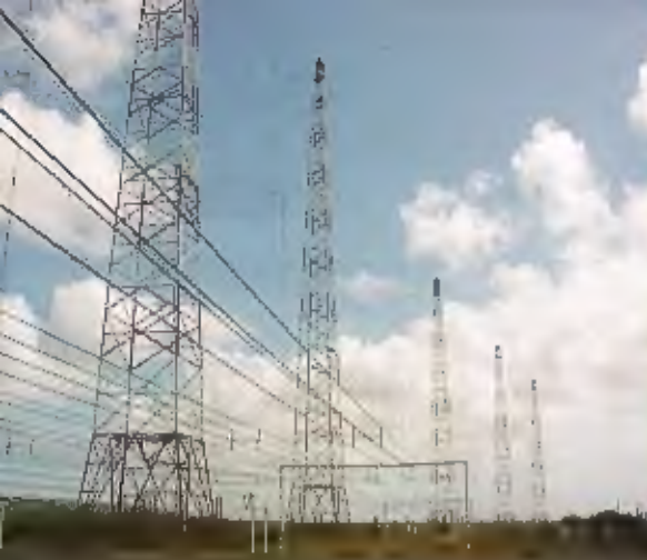
Deel antennepark op zendstation Wereldomroep in Bonaire
